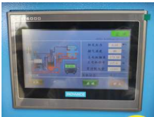
空氣壓縮機的操作介面
