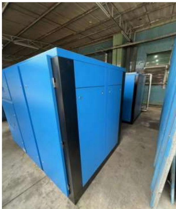
2 台 110kW 永磁電機及變頻的空氣壓縮機
